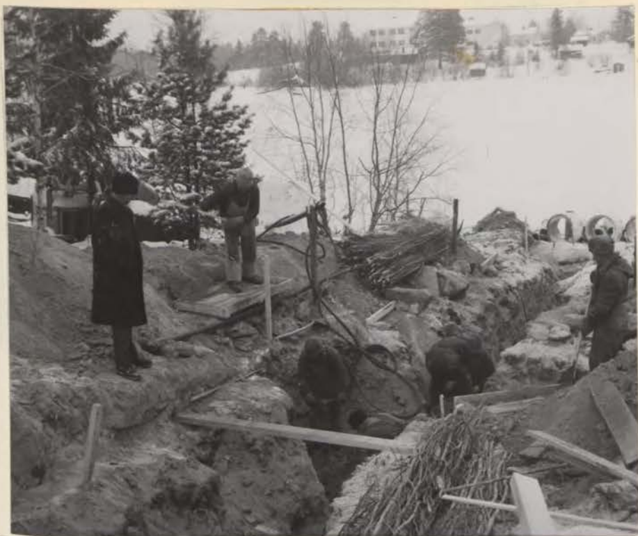
Vatten- och avlopp — ett alltid aktuellt problem.
